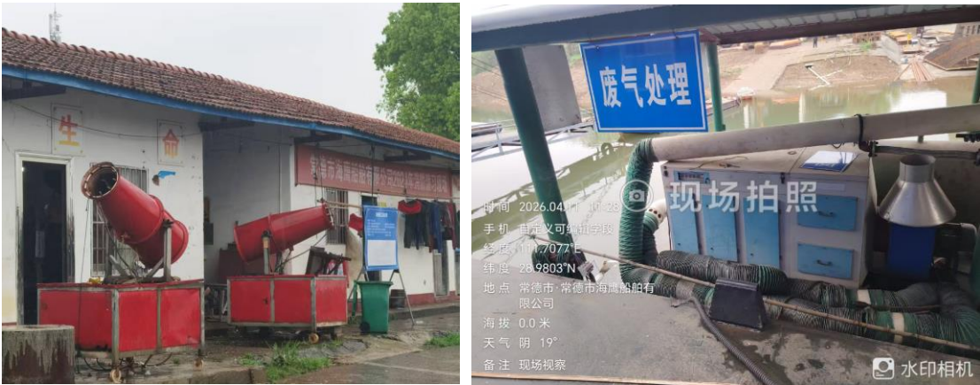
图 3.1-3 厂区移动式降尘雾炮机（部分）与移动式油漆废气净化器
