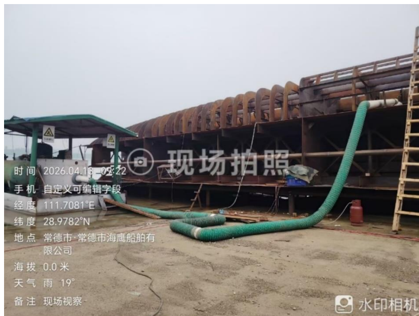
图 3.1-3 移动式油漆废气净化器现场照片
