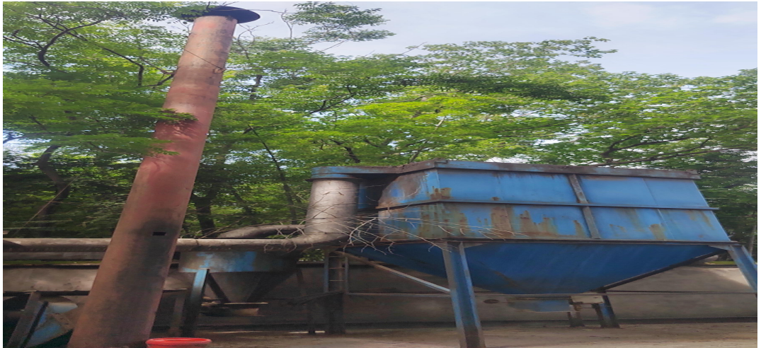
锅炉废气治理设施现状照片
